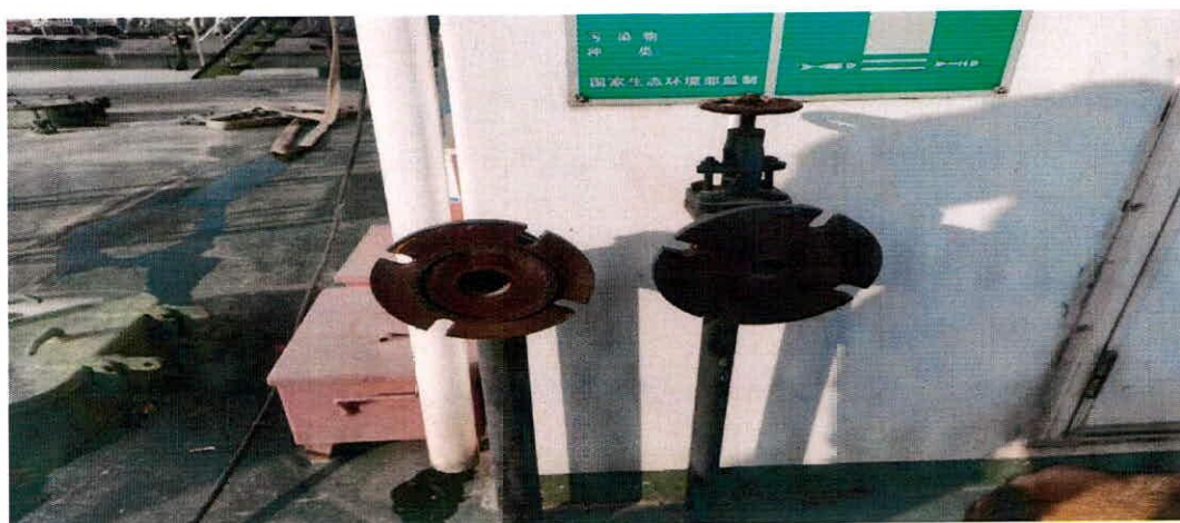
生活污水存储箱及计量器
